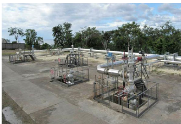
Figure 4. Vue des têtes de puits de production du champ de Bouillante sur l'île de la Guadeloupe [Source : photo CFG services]
