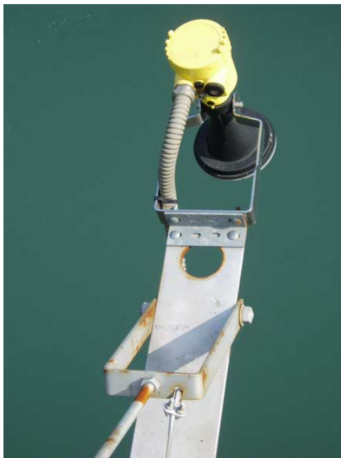
Figure 5. Mesure de niveau par radar émergé [Source : crédit photo EDF DTG].
