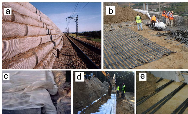
Figure 2. Renforcement des massifs de soutènement. (a) Mur renforcé par géosynthétiques ; (b) renforcement par géogrilles ; (c) Renforcement par nappes géotextiles ; (d) Renforcement par structures alvéolaires (procédé Armater [1]) et (e) renforcement par bandes géotextiles.
