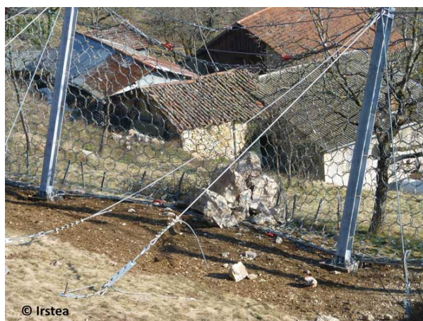
Figure 9. Filets déformables, Ripaille [Source : IRSTEA]
