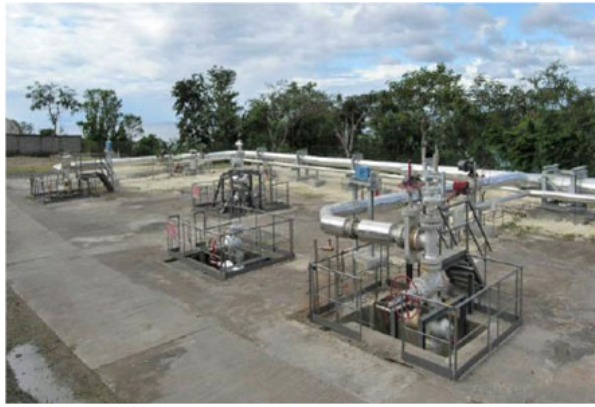
Figure 4. Vue des têtes de puits de production du champ de Bouillante sur l'île de la Guadeloupe [Source : photo CFG services]
