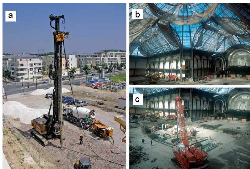
Figure 1. Renforcement du sol en place. a) Inclusions rigides [Source : © Photothèque Keller] b et c) Renforcement des fondations du grand Palais [© Photothèque Solétanche Bachy].
