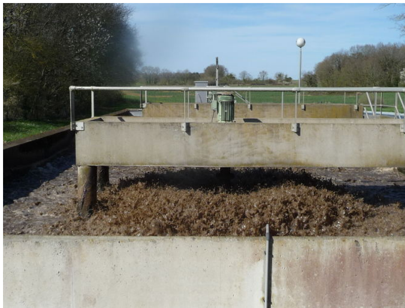
Figure 6. Bassin de boues activées aéré à l'aide d'un agitateur mécanique. [Source : © Joseph De Laat]
